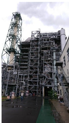
バイオマス発電所
